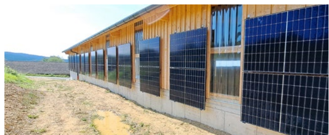
Photovoltaik an der Fassade eines Betriebsgebäudes für eine effiziente Nutzung der Flächen
