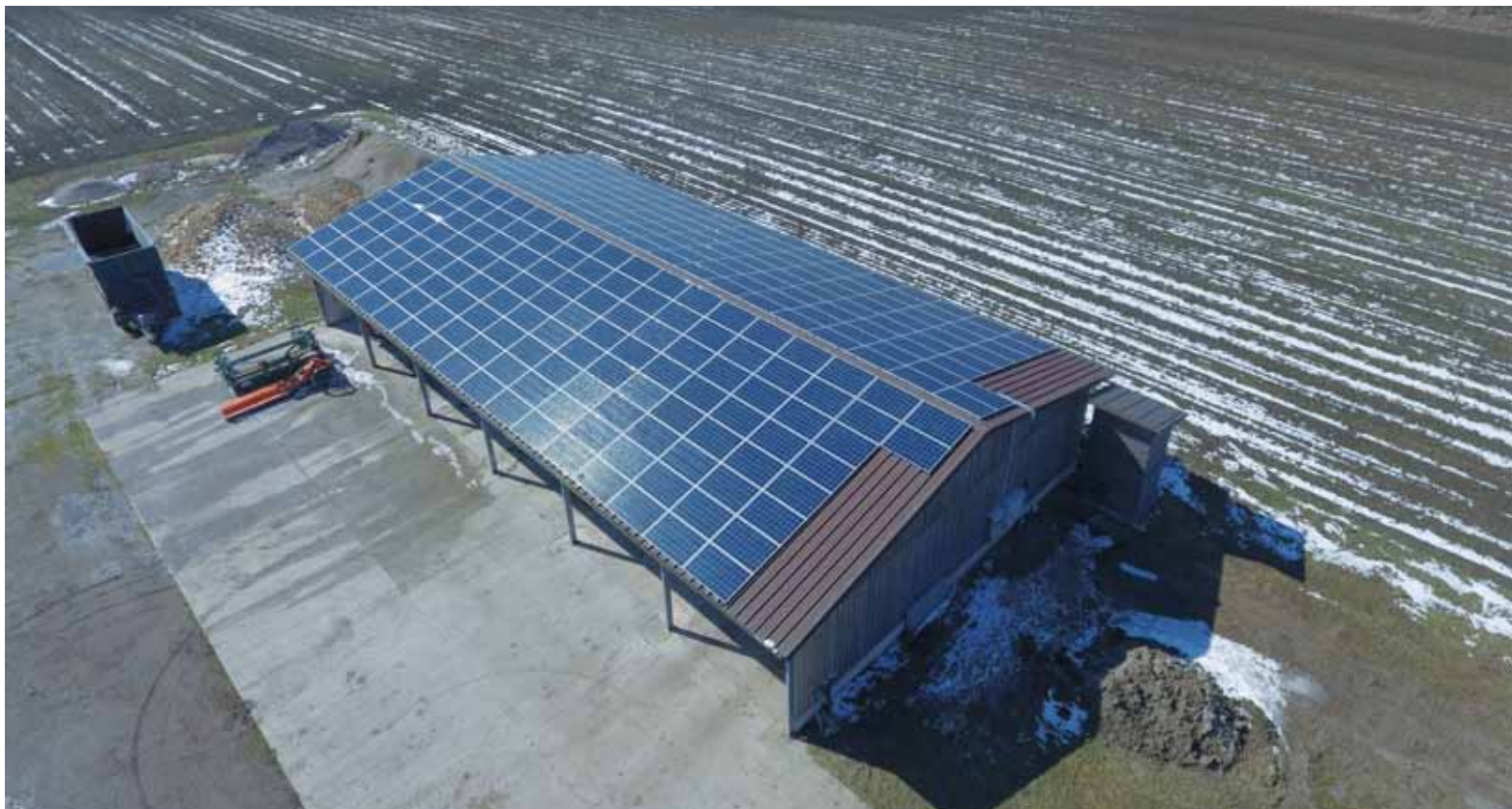
Neues von der Energiewendepartnerschaft: Die erste von zwei Anlagen nahm im burgenländischen Pötttsching ihren Betrieb auf.
