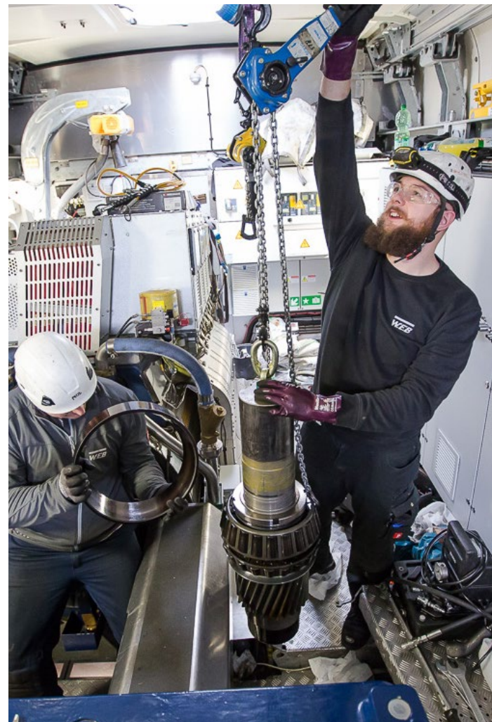
Ein detaillierter Störungsauftrag ist wichtig für die W.E.B-Servicetechniker, um die Arbeiten an der Anlage effizient durchführen zu können.
